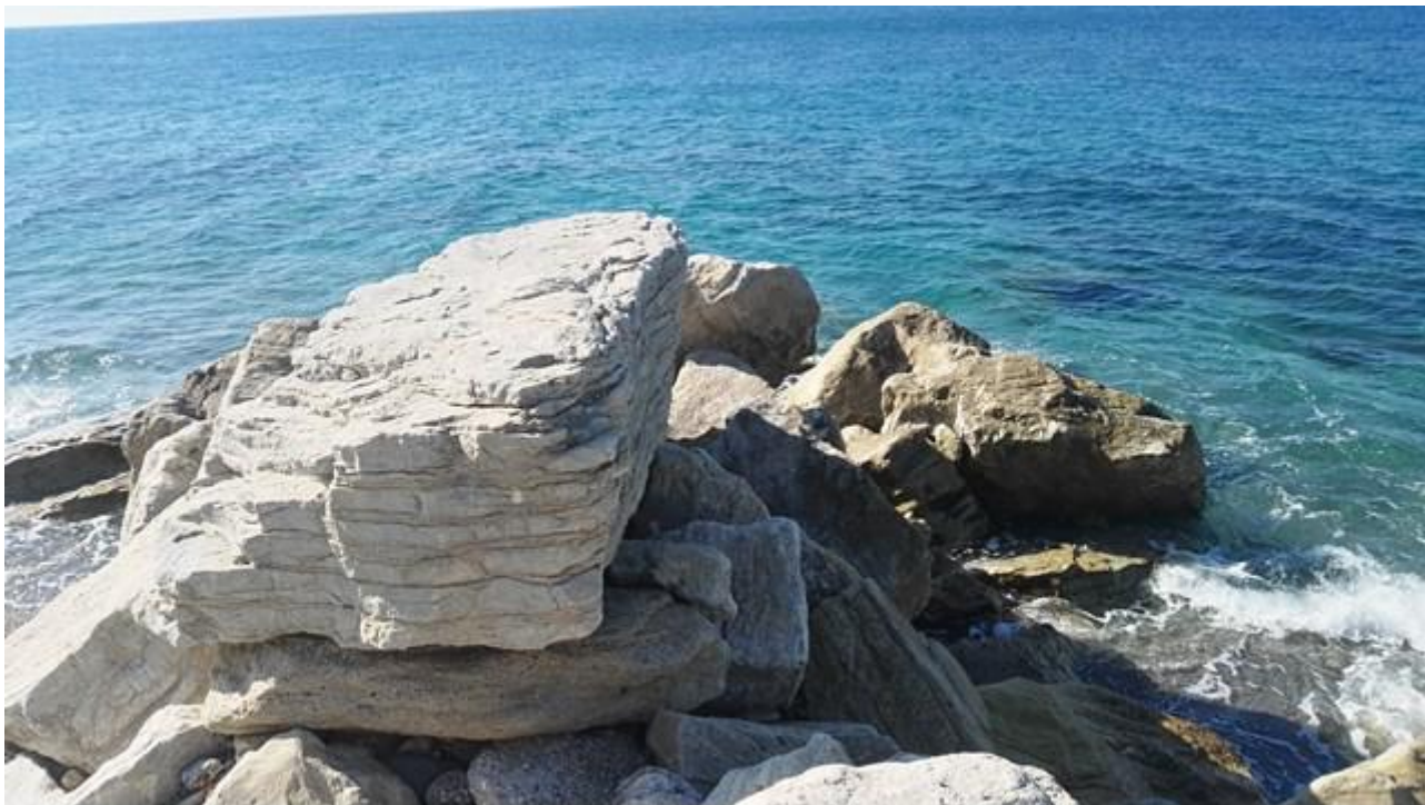
Figura 29 Foto 25 Pennello Torrente Oliveto zona C Lazzaro
